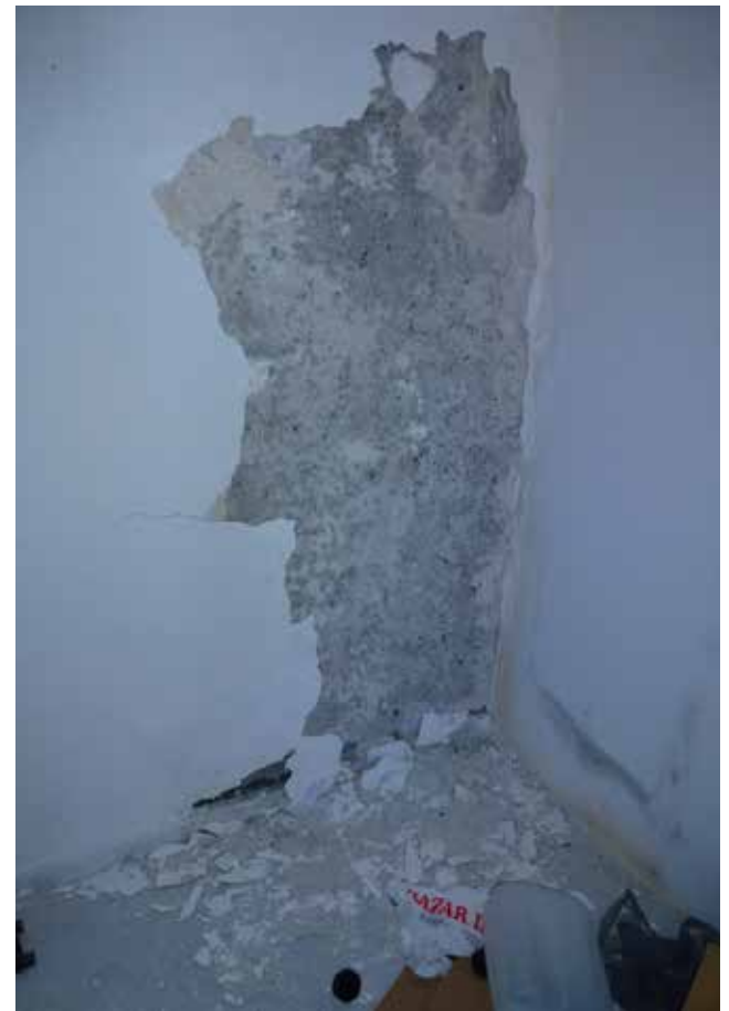
Foto 17 - Dettaglio delle infiltrazioni nella camera nordovest
