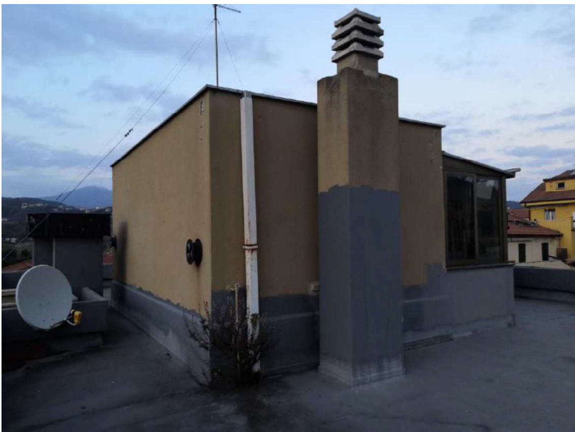
Foto 22: VEDUTA GENERALE DEL FABBRICATO IN CUI RICADE L'IMMOBILE OGGETTO DI STIMA – PIANO TERZO
