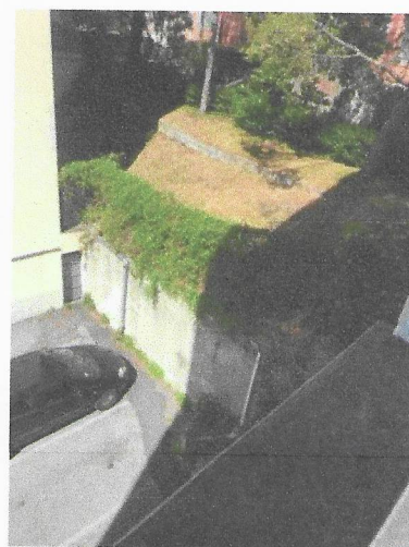
distacco condominiale dalla finestra del corridoio
