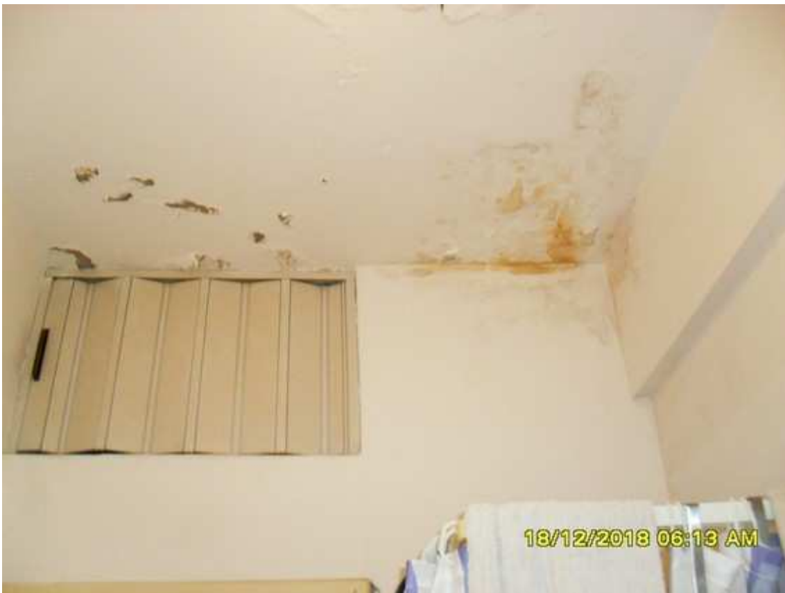
Foto 14: Macchie dovute ad infiltrazioni provenienti dal piano soprastante
