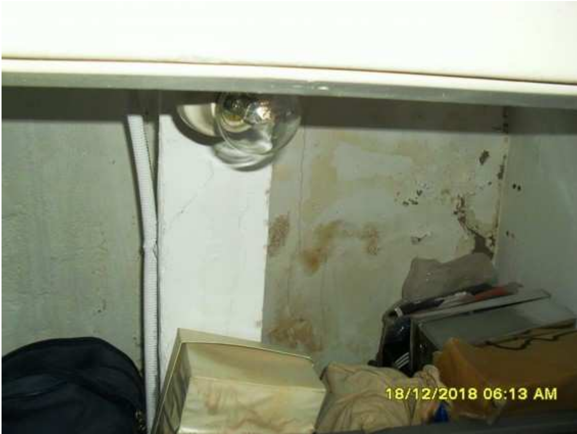
Foto 17: Soffitto della dispensa danneggiato da infiltrazioni provenienti dal piano soprastante
