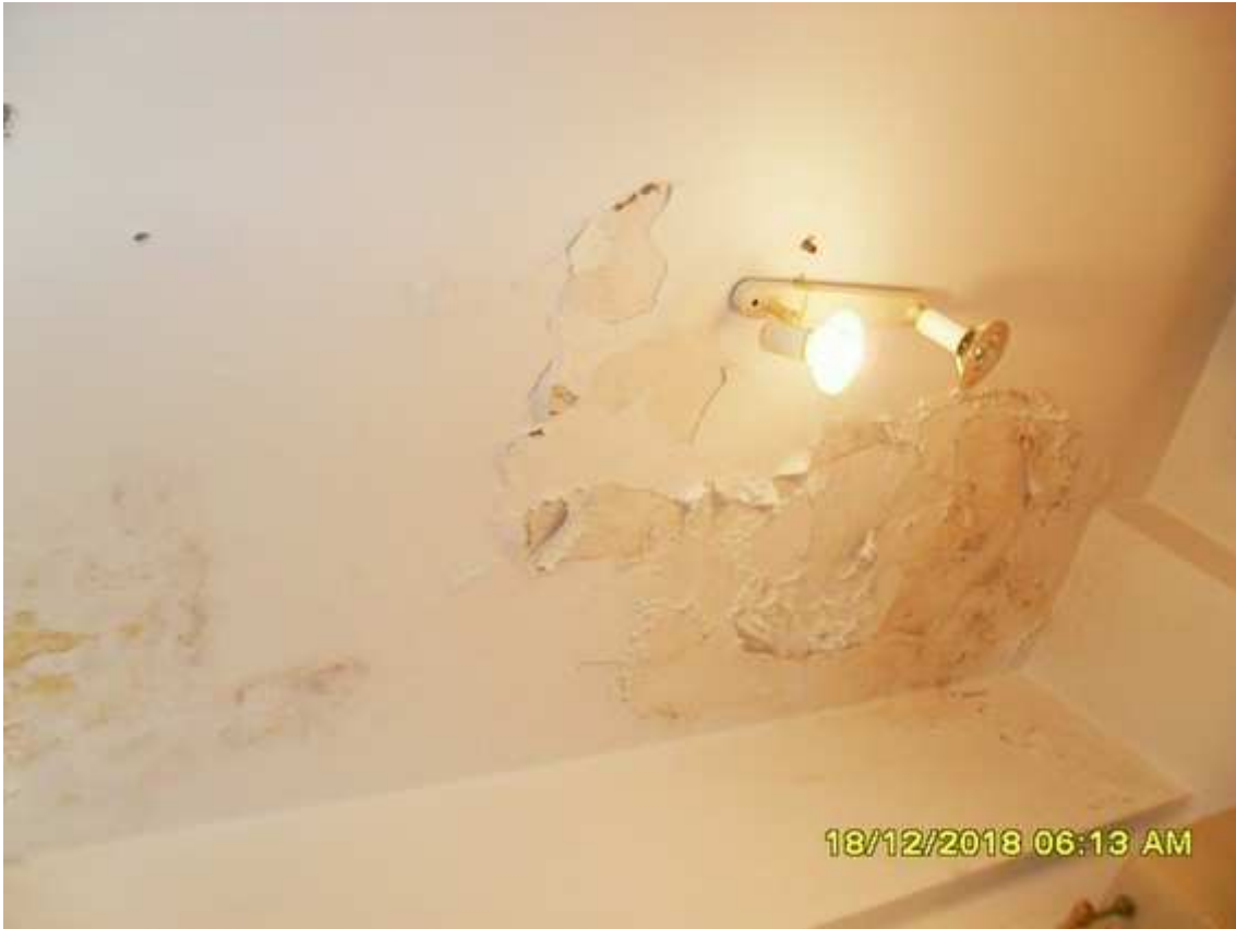
Foto 15: Macchie dovute ad infiltrazioni provenienti dal piano soprastante
