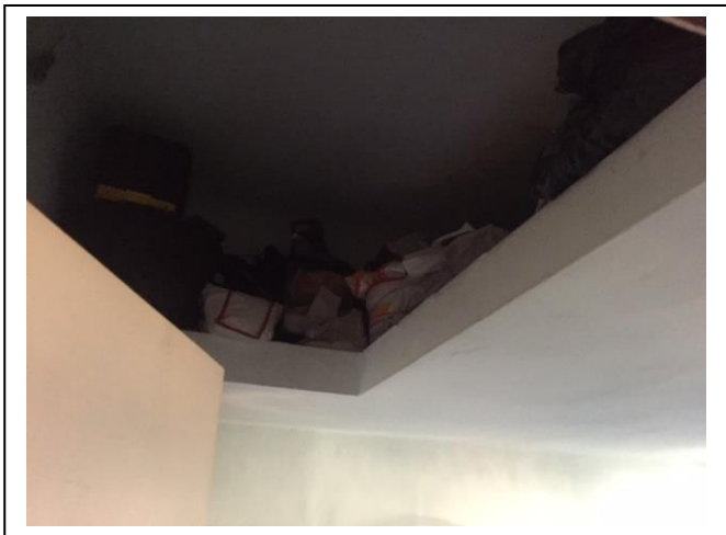
Foto n. 13 : controsoffitto nel servizio igienico
