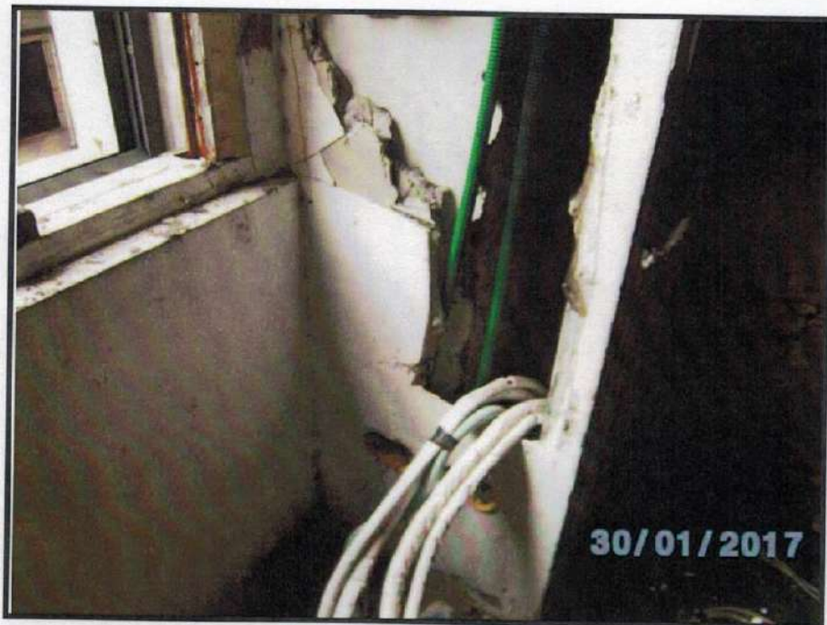
FOTO N.12 - PARTICOLARE FINESTRA MANCANTE SU VIA CARDUCCI
