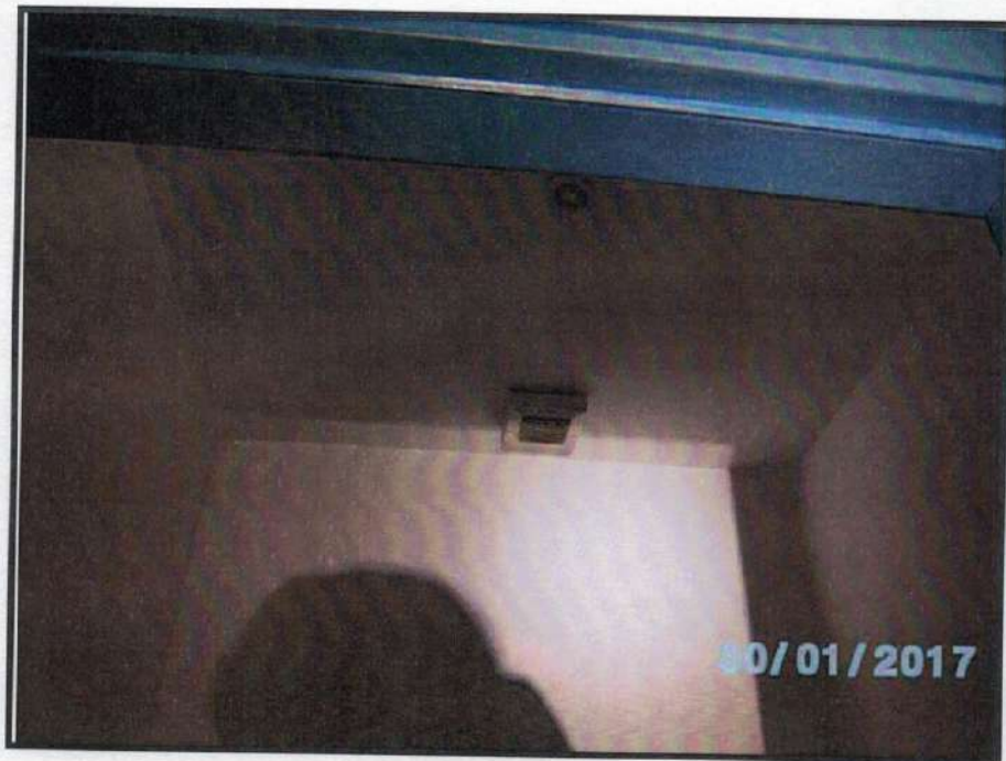
FOTO N.20 - SECONDO BAGNO ASPIRAZIONE FORZATA
