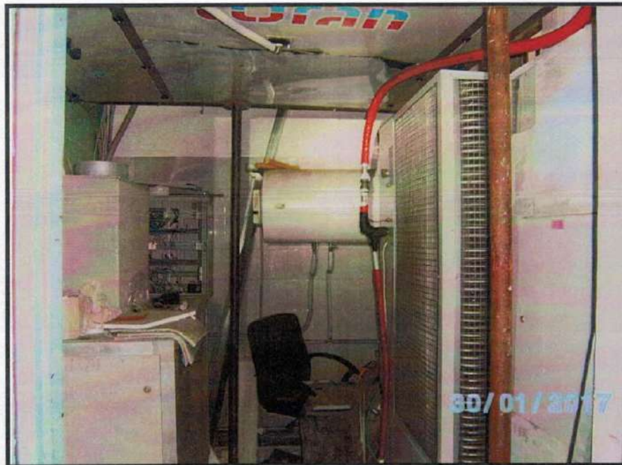
FOTO N.32 - PIANO PRIMO LOCALE MOTORI
