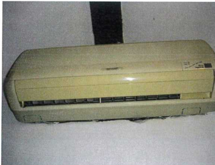
Vista del condizionatore installato nell'ingresso
