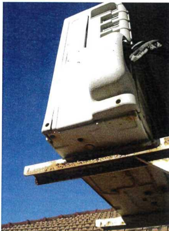
Vista del condizionatore (unità esterna)
