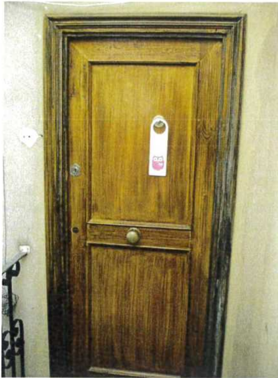
Particolare del portoncino d'accesso all'appartamento
