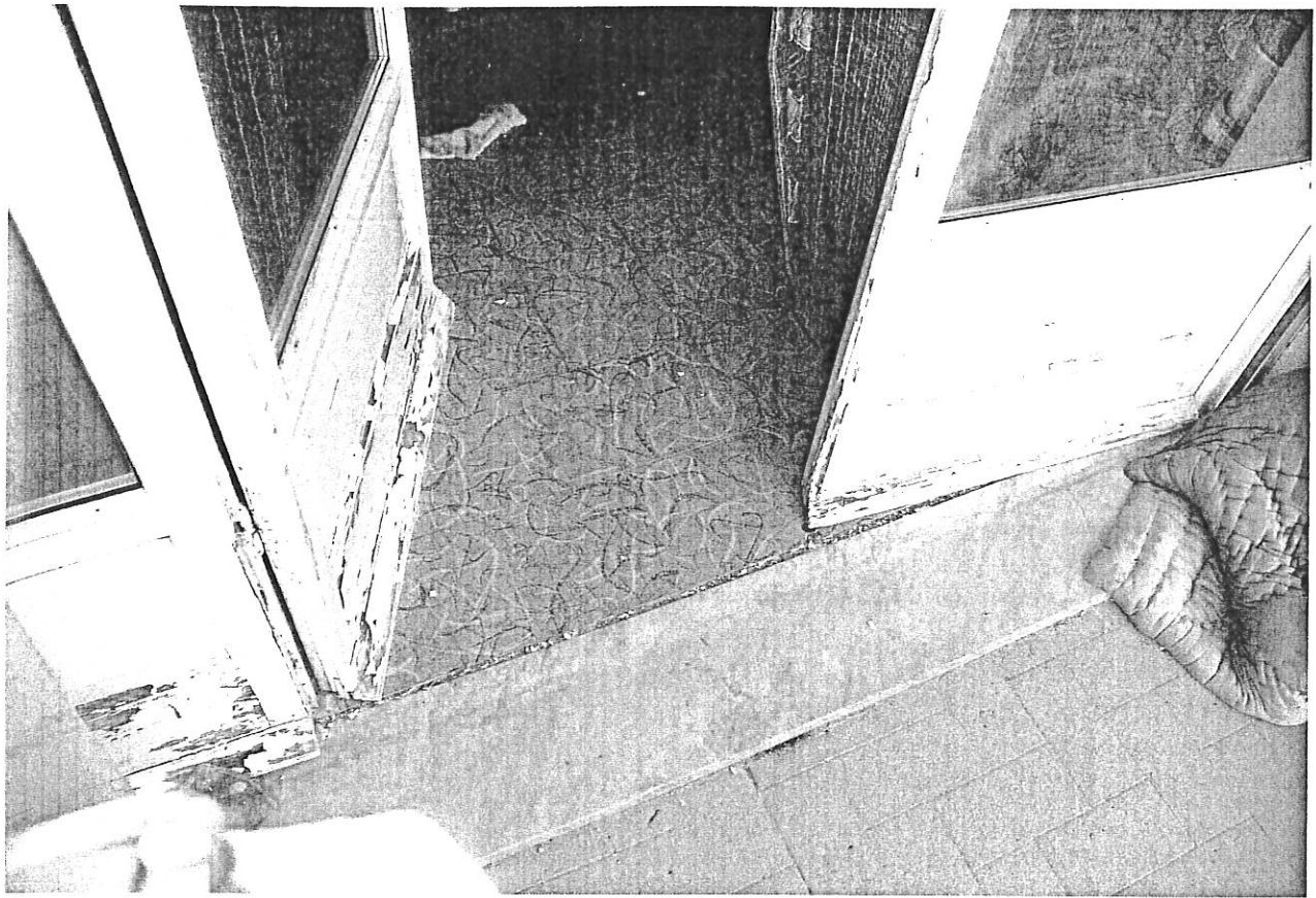
Foto n.35- Particolare portafinestra camera 3 , soglia e pavimento
