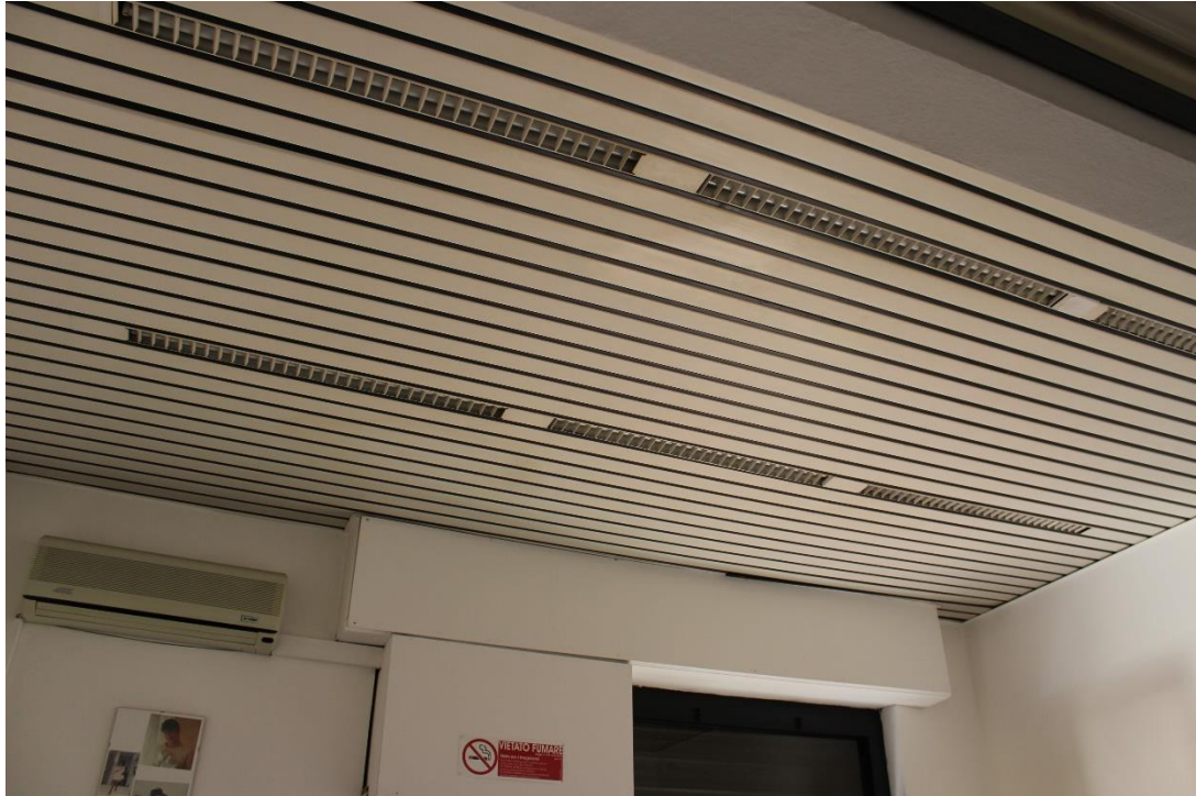
Controsoffitto a doghe
