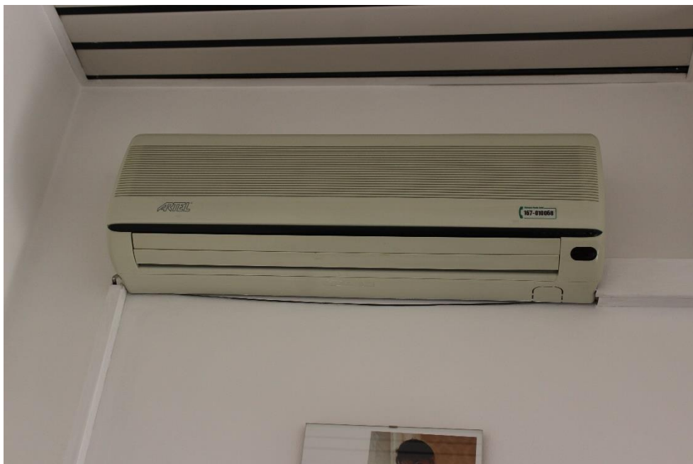
Impianto di condizionamento
