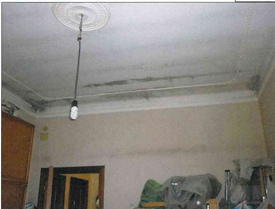
Foto n° 29 – Stato di condizioni di soffitto e pareti Camera 2
