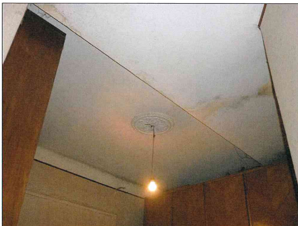
Foto n° 16 – Stato di condizioni di soffitto e pareti Camera/Ripostiglio
