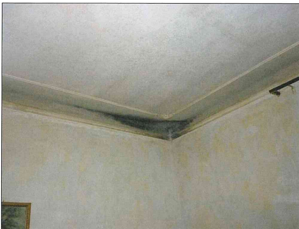
Foto n° 21 – Stato di condizioni di soffitto e pareti Camera 1
