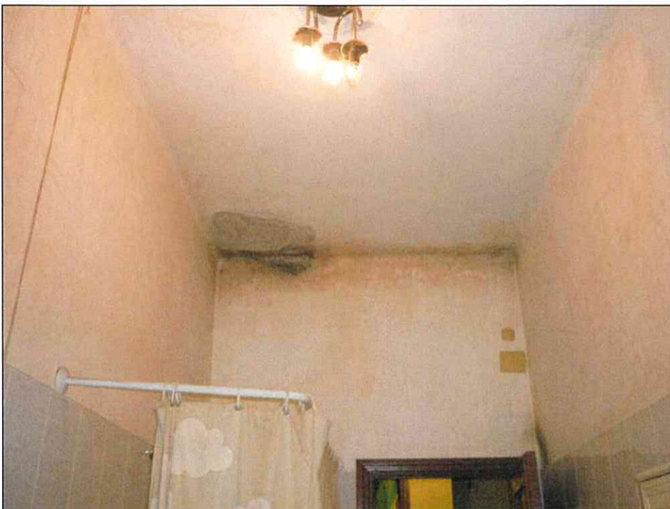
Foto n° 18 – Stato di condizioni di soffitto e pareti Bagno
