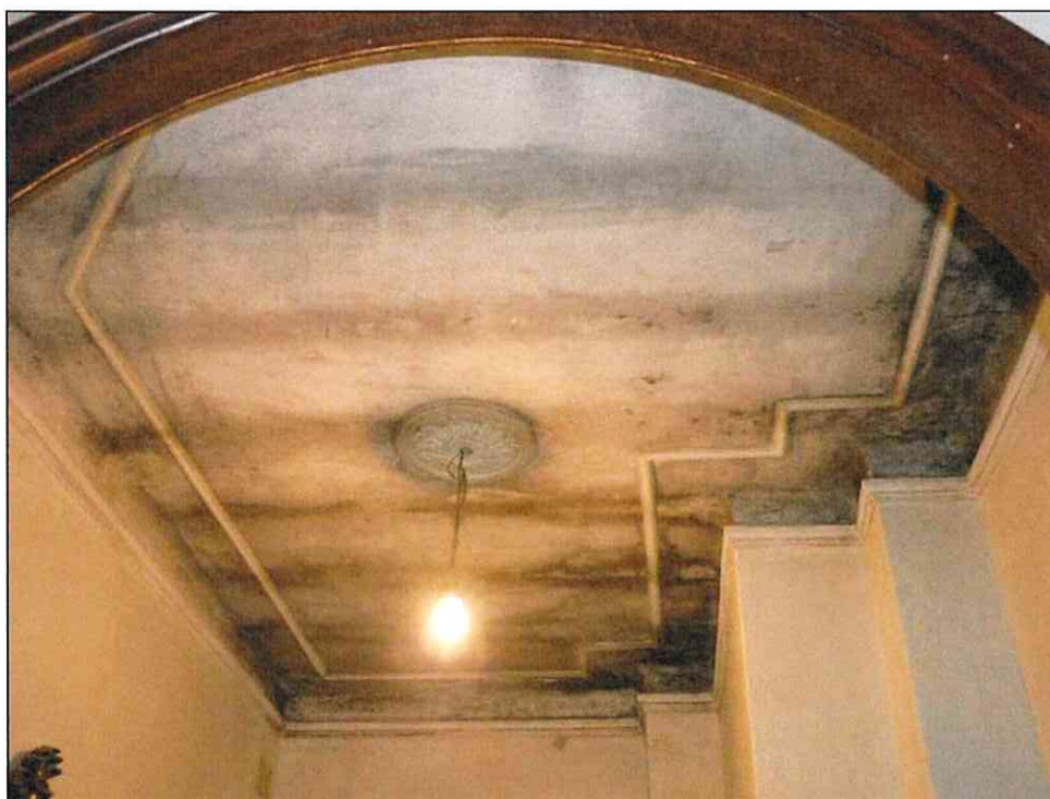
Foto n° 8 – Stato di condizioni del soffitto Ingresso
