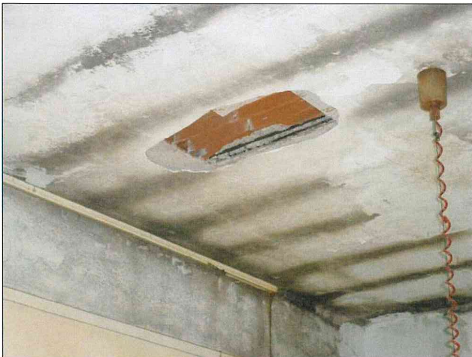
Foto n° 24 – Stato di condizioni di soffitto e pareti Cucina
