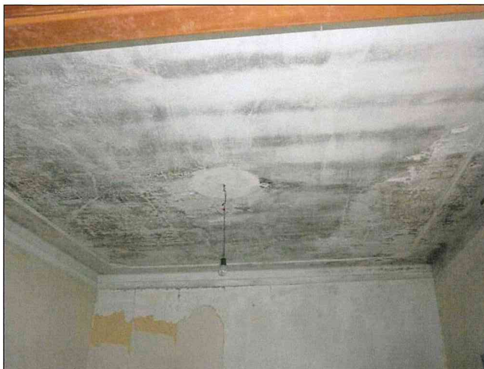
Foto n° 13 – Stato di condizioni di soffitto e pareti Pranzo-Soggiorno
