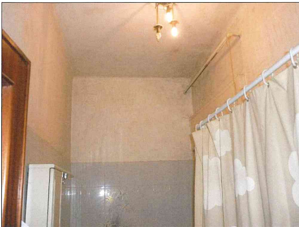
Foto n° 19 – Stato di condizioni di soffitto e pareti Bagno
