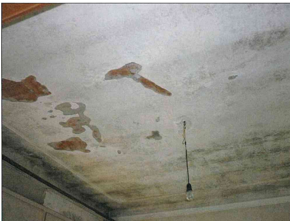
Foto n° 12 – Stato di condizioni di soffitto e pareti Pranzo-Soggiorno
