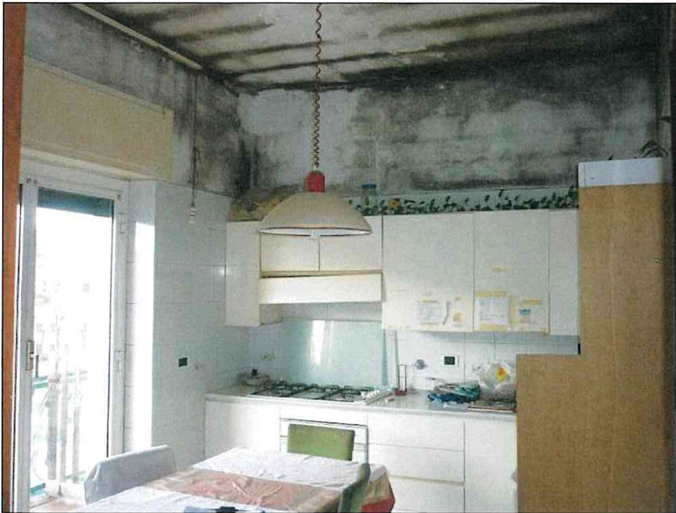
Foto n° 23 – Stato di condizioni di soffitto e pareti Cucina
