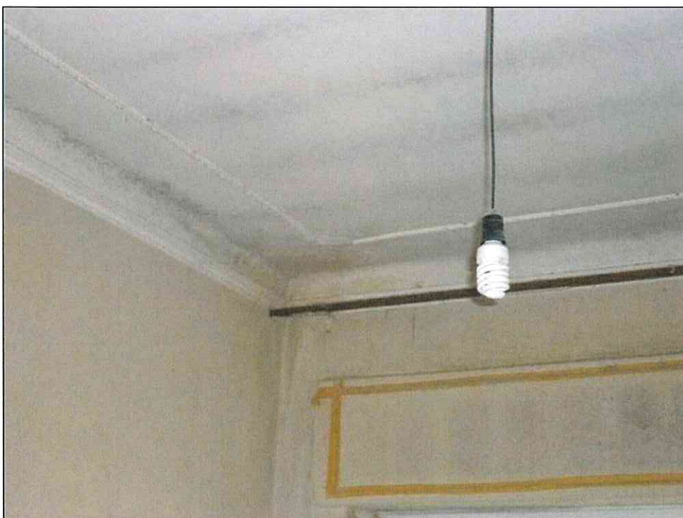
Foto n° 28 – Stato di condizioni di soffitto e pareti Camera 2
