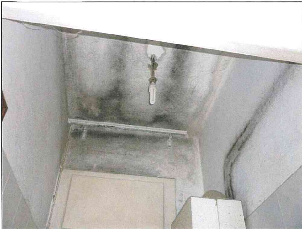
Foto n° 26 – Stato di condizioni di soffitto e pareti Bagno di servizio
