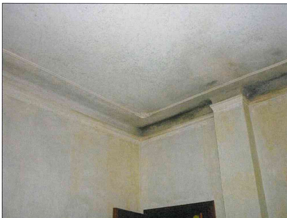
Foto n° 22 – Stato di condizioni di soffitto e pareti Camera 1
