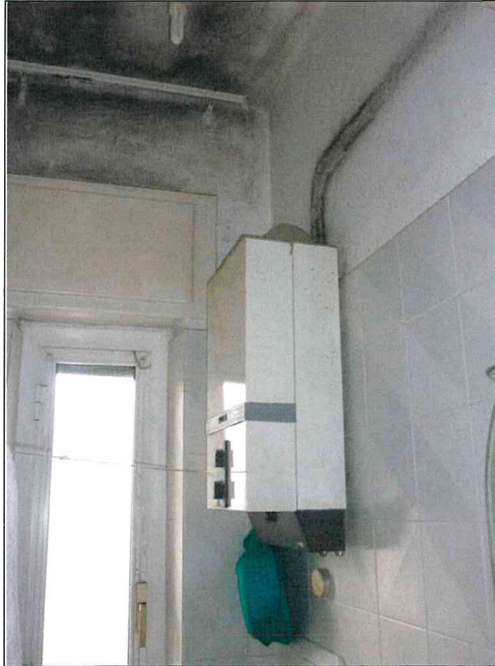
Foto n° 25 – Stato di condizioni di soffitto e pareti Bagno di servizio
