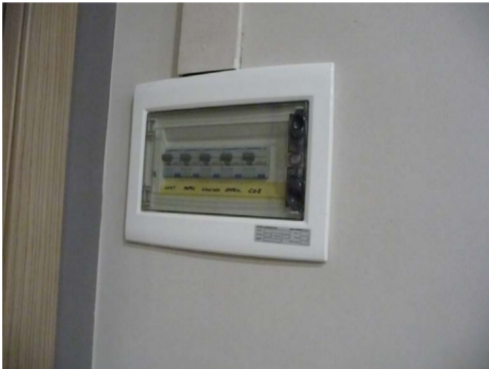
Foto n 11 Quadro elettrico
