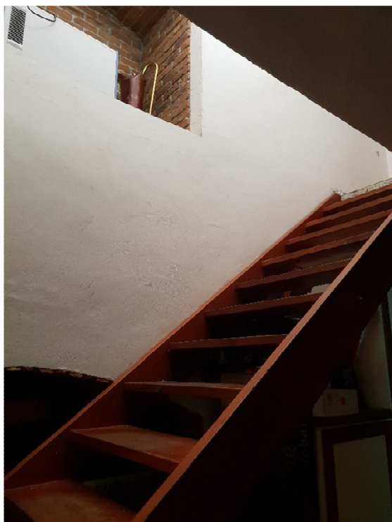
Foto 35: scala da cucina al sottostante piano 1° - piano abusivo
