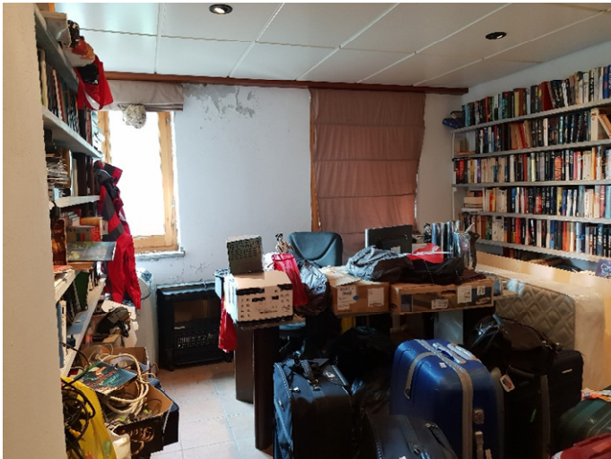
Foto 41: Locale deposito piano ammezzato abusivo
