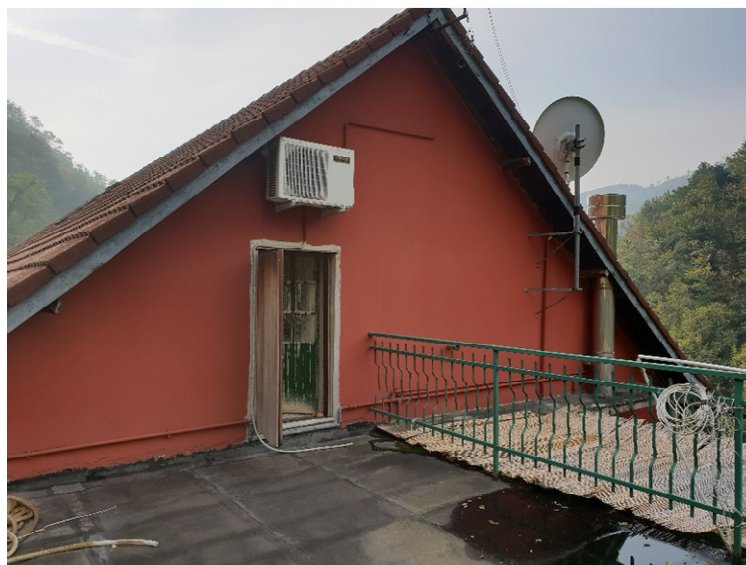
Foto 34: porta finestra da camera 3 su lastrico solare non praticabile – P. 3° sottotetto
