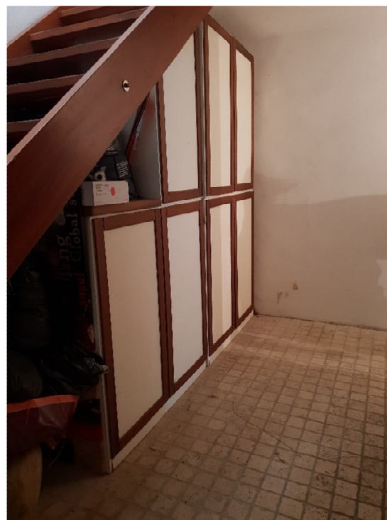
Foto 36: pianerottolo disimpegno piano 1° - piano abusivo
