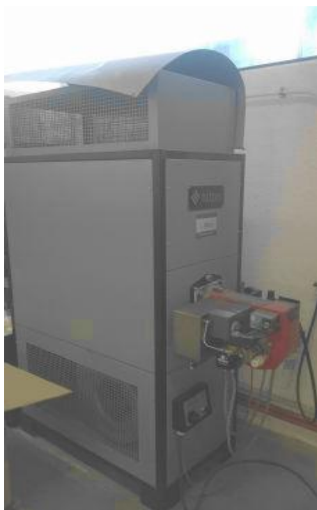
FOTO N° 30 PIANO TERRA - CALDAIA DISMESSA
