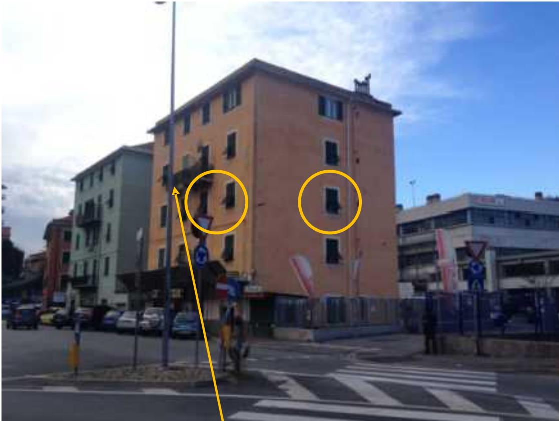
FOTO 1: Scorcio nord/est del civ. 5 di Via Colano. Segnate con cerchi gialli le finestre dell'int. 6. Con freccia il balcone degradato dell'int. 7 che ha determinato l'installazione della mantovana di protezione.
