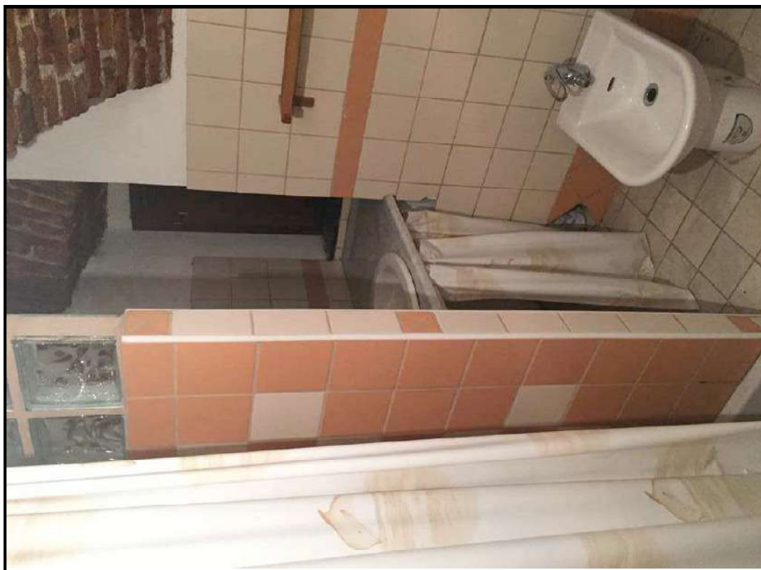
Foto 27 – Cantine Piano Terra (Alloggio abusivo) Via Fegino 5 (Lotto 4°)
