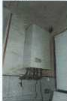
Particolare della calderina
