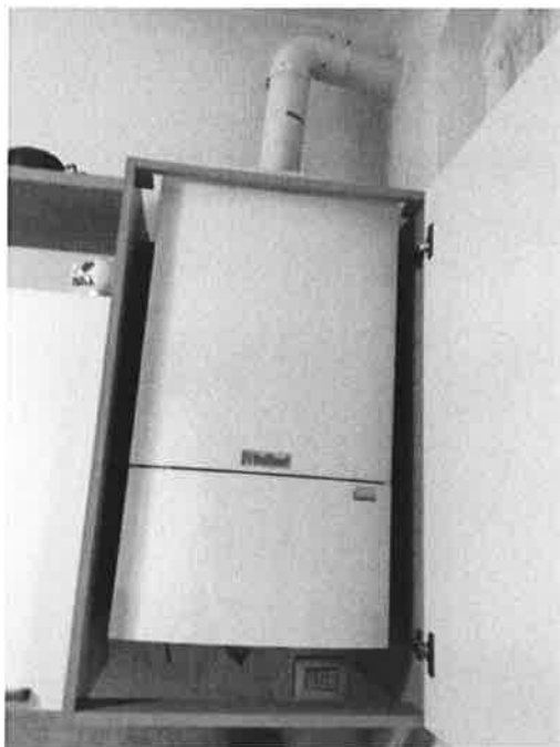
Foto n° 15 – Vista impianti- caldaia
