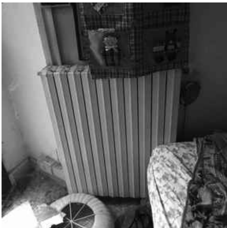
Foto n° 26 – dettagli impianti – elementi radianti
