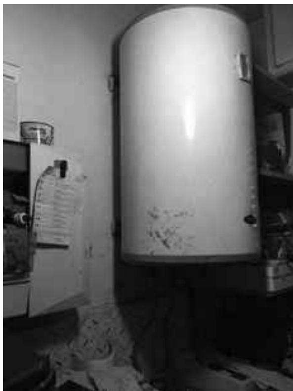
Foto n° 25 – dettagli impianti – boiler produzione acqua calda sanitaria
