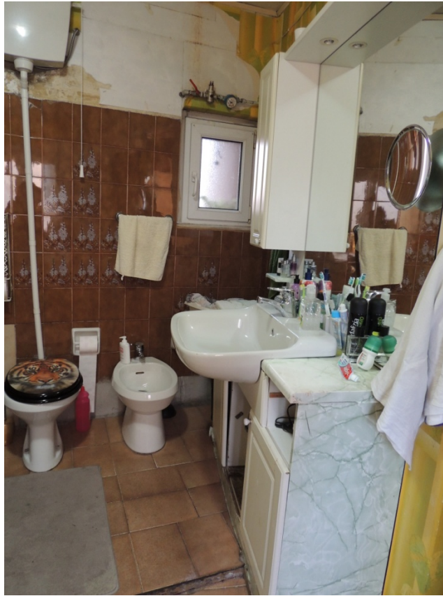
Foto n 12 Bagno con evidenziate varie infiltrazioni
