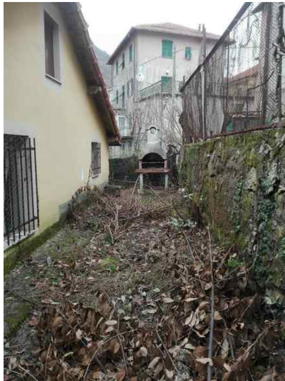
Vista distacco facciata est
