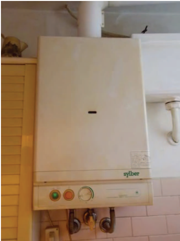
Particolare del generatore di calore per ACS
