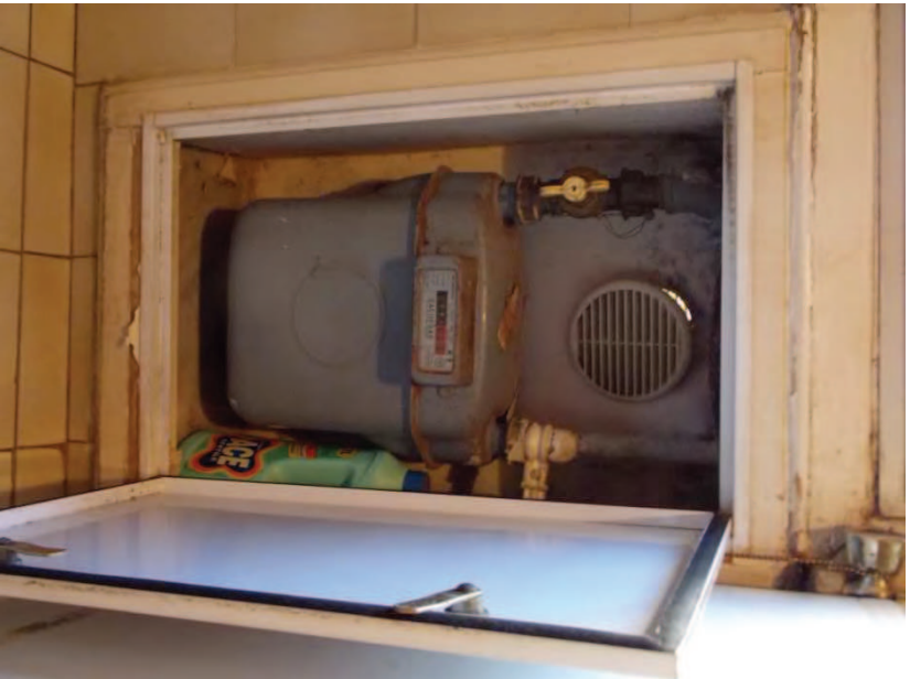
Particolare del contatore gas metano
