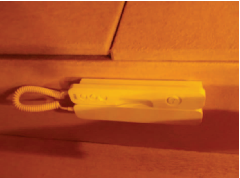
Particolare dell'impianto citofonico
