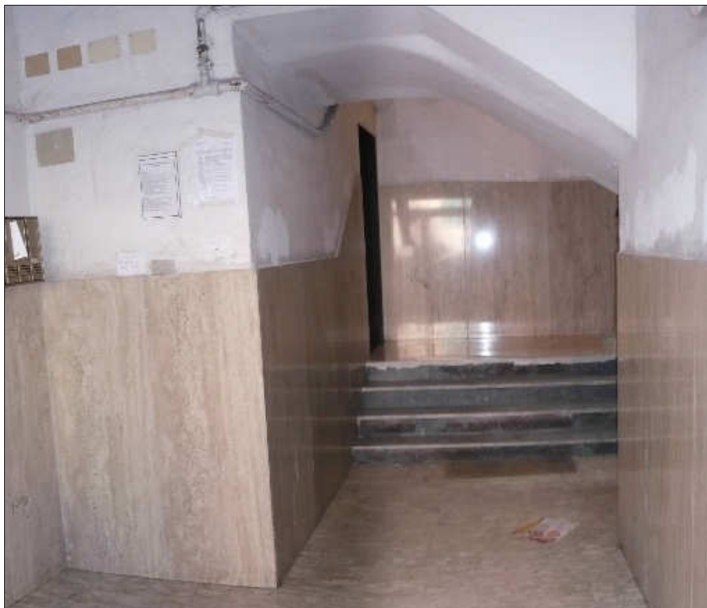
Foto 3) Le mediocri condizioni manutentive in cui versa l'androne d'ingresso.
