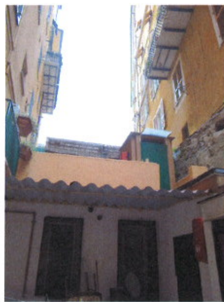
FOTO 8 - distacco di proprietà
