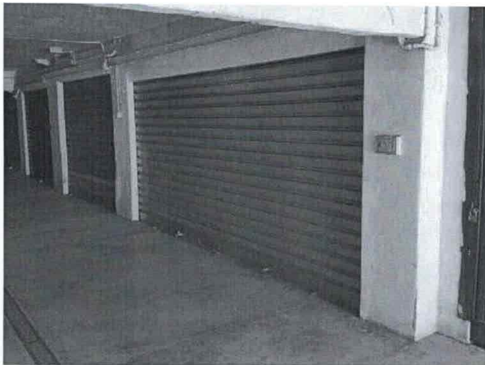
FOTO 8—serranda esterna motorizzata
