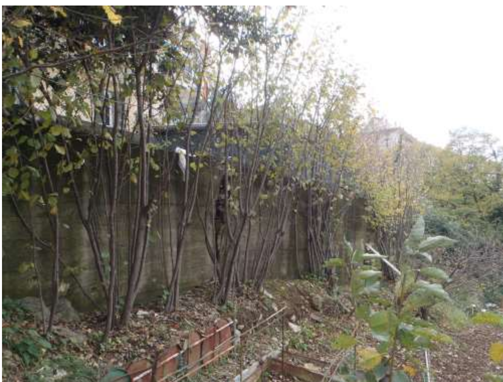
FOTO 48— MURO DI CONFINE NORD CON IMPORTANTE LESIONE
