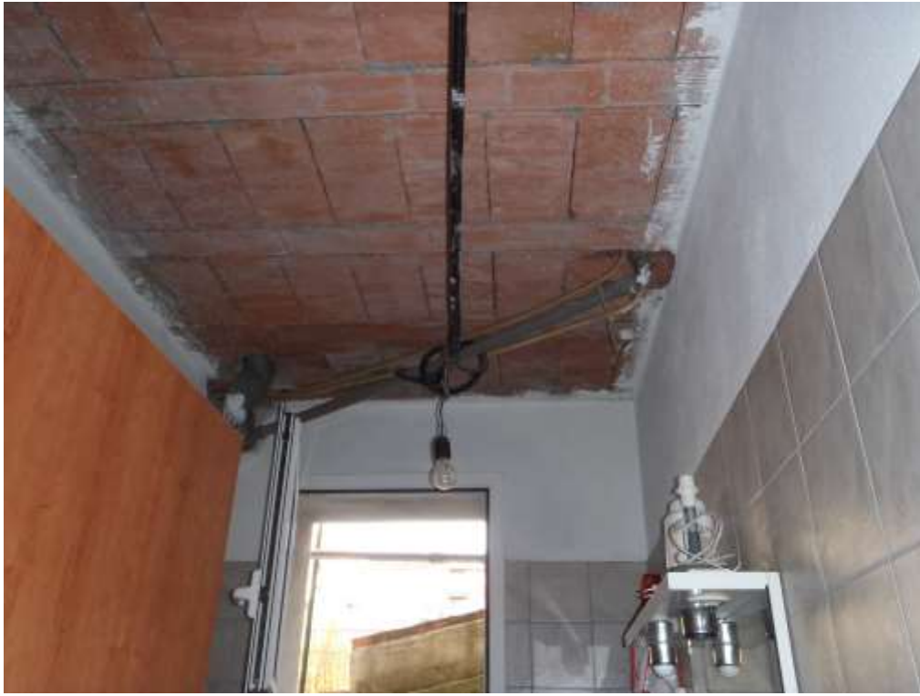
FOTO 43— PARTICOLARE SOFFITTO WC CON SCARICHI A VISTA
