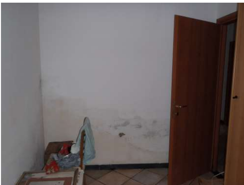
FOTO 40—UMIDITA' DA RISALITA NEL LOCALE 4
