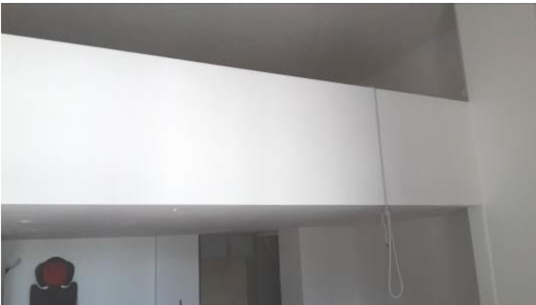
FOTO 6: Vista soppalco non autorizzato
